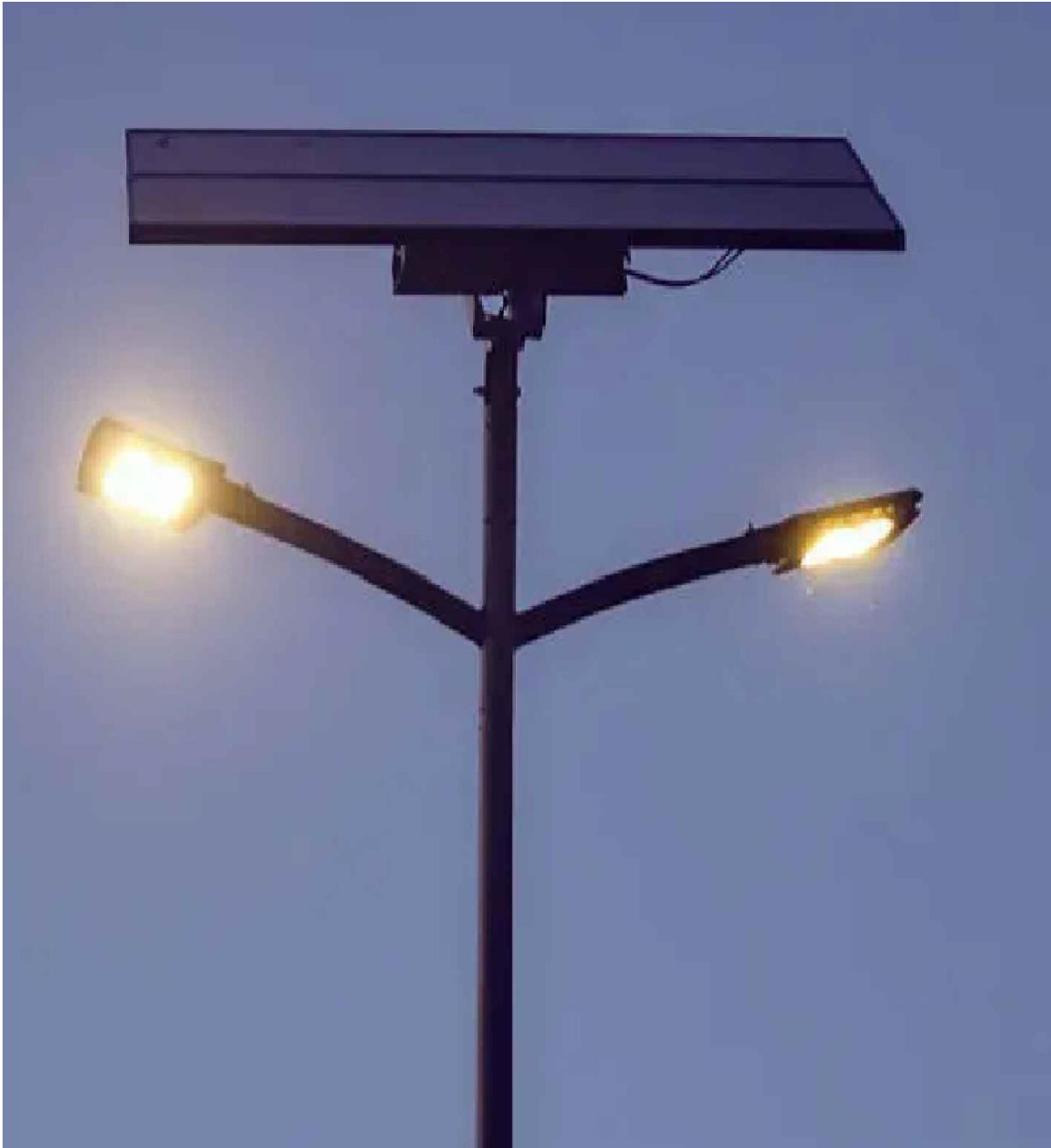
Figura 2 – Torre de iluminação fotovoltaica (vista noturna em funcionamento)
